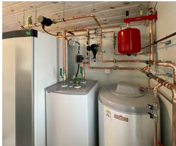
Rørleggeren har anstrengt seg for å gjøre anlegget kompakt slik at det beslaglegger minst mulig bodareal for Bjørnar Rydheim.
